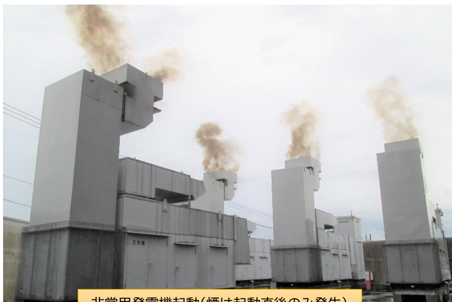
非常用発電機起動(煙は起動直後のみ発生)
