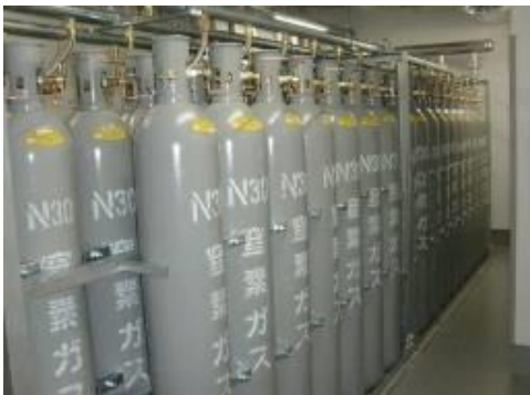
窒素ガス消火設備ボンベ庫
